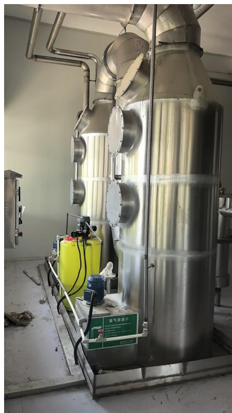
二级碱液喷淋装置
