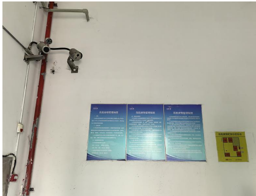
危废库内部视频监控
