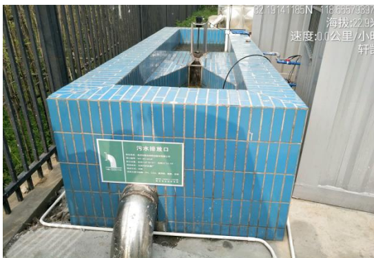
污水处理站排口
