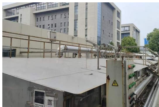
厂内污水处理站
