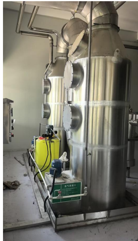
二级碱液喷淋装置
